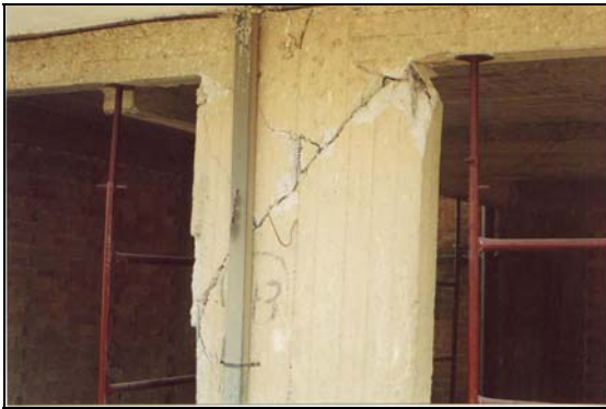
Σχ.18: Διαμπερής διαγώνια ρωγμή σε υποστήλωμα
