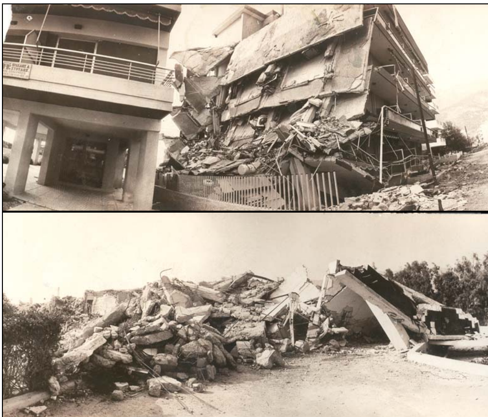
Σχ.1: Δύο περιπτώσεις ολικής κατάρρευσης κτιρίων στο Λουτράκι
