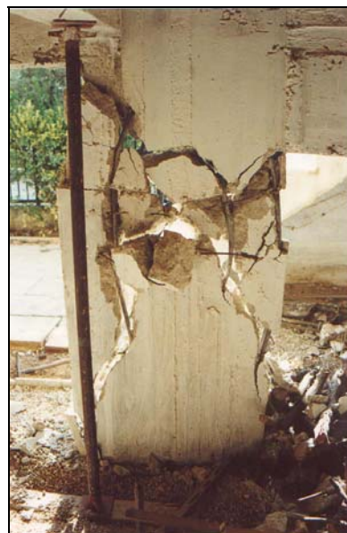
Σχ.15: Διατμητική αστοχία υποστηλώματος με αποδιοργάνωση σκυροδέματος και λυγισμός οπλισμού
