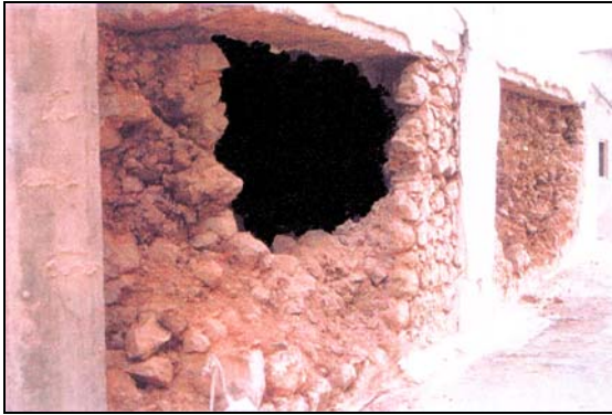
Σχ.16: Κατάρρευση τμήματος τοιχοποιίας πληρώσεως
