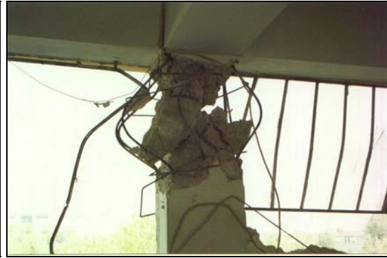
Σχ.17: Βλάβη σε κόμβο και λυγισμός οπλισμού
