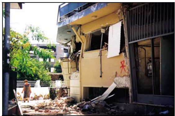
Σχ.19: Θραύση γωνιακής περιμετρικής δοκού
