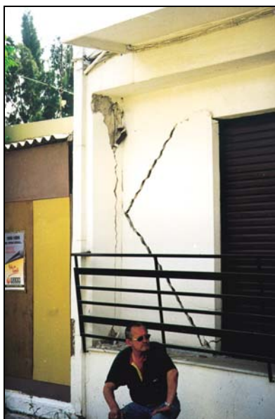
Σχ.14: Αποκόλληση οπτοπλινθοδομής πληρώσεως και ρηγματώση από διάτμηση
