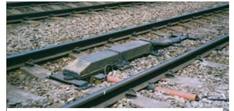
Ράμπα συστήματος AWS μεταξύ των σιδηροτροχιών
